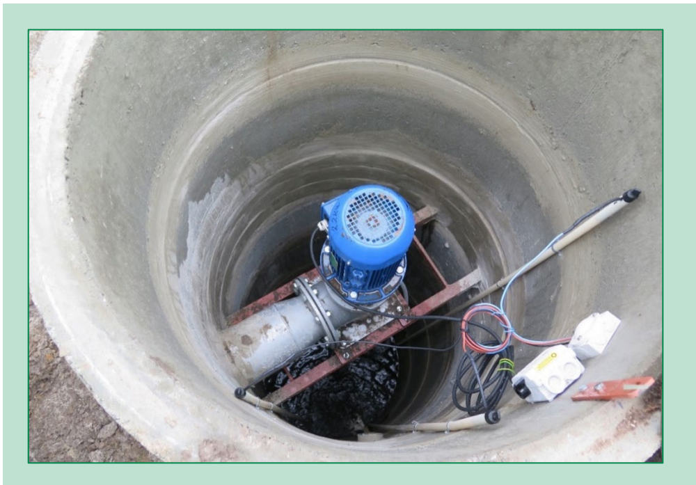
FIGUR 2.4.1. Den nyetablerede pumpe, hvis kapacitet er afstemt i forhold til den projekterede vandgennemstrømning i matriceanlægget og det åbne bassinanlæg.
