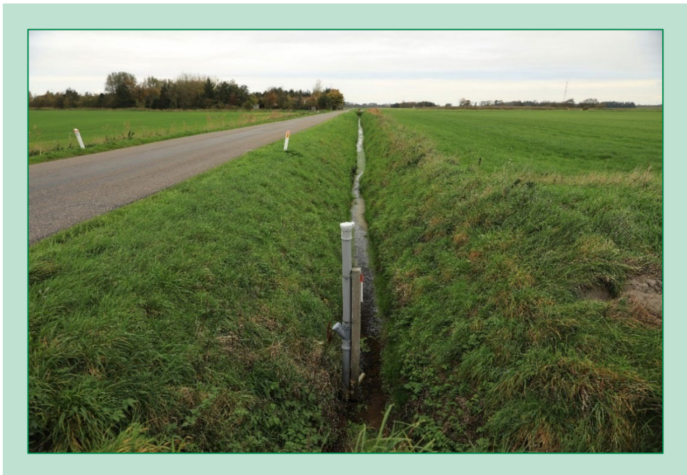
FIGUR 2.5.2. Online vandstandslogger i aflastningsgrøften langs Slusevej. I hovedparten af tiden strømmer vandet i retning mod pumpen ved de to minivådområder, og kun i forbindelse med ekstraordinært store afstrømninger er der mulighed for at vandstrømmen vendes i retning mod hovedpumpen opstrøms Haldager Bro, som derved aflaster pumpen i projektområdet. Grøftens dimensioner og især gennemstrømningsåbningens størrelse i de mange overkørsler over grøften betyder, at grøftens vandføringsevne er begrænset.
