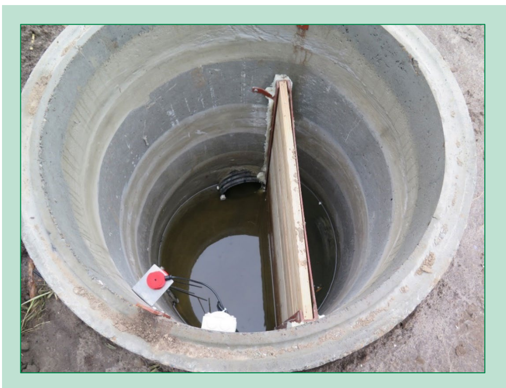
FIGUR 2.4.2. Fordelerbrønden hvori vandet fra pumpen fordeles med ca. 10 l/s via en vandbremse til matriceanlægget og ca. 25 l/s til det åbne bassinanlæg.
