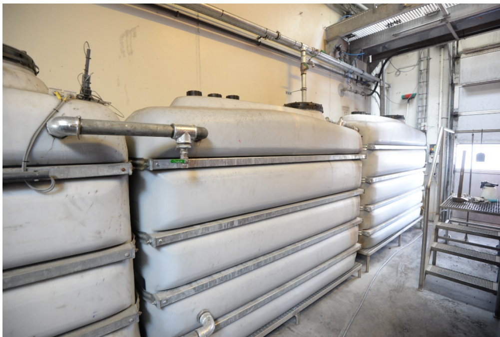
Indløbsvandet til DPF-anlægget i Assens havde gennemgået værkets normale renseproces som bl.a. indeholder bundfældning i disse tanke. Foto: Simon Skov
