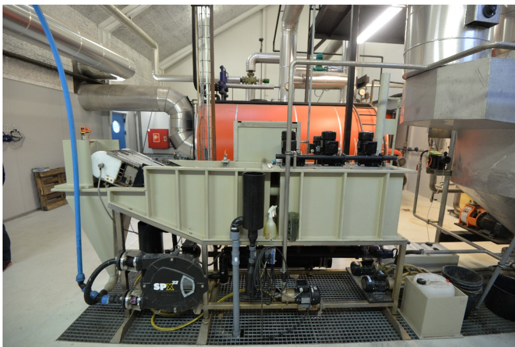
Klassisk båndfilter på flisfyret vameværk. Foto: Simon Skov
