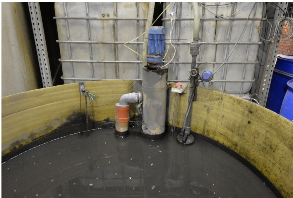
Eksempel på bundfældningstank på et flisfyret varmekværk. Foto: Simon Skov
