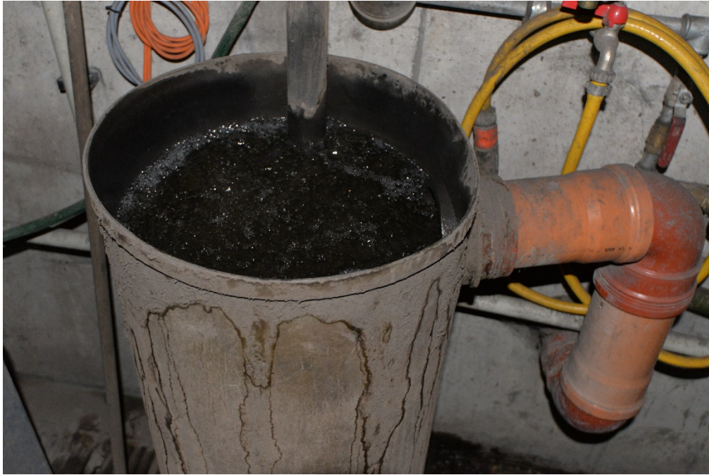
Udløb til offentlig kloak. Foto: Simon Skov
