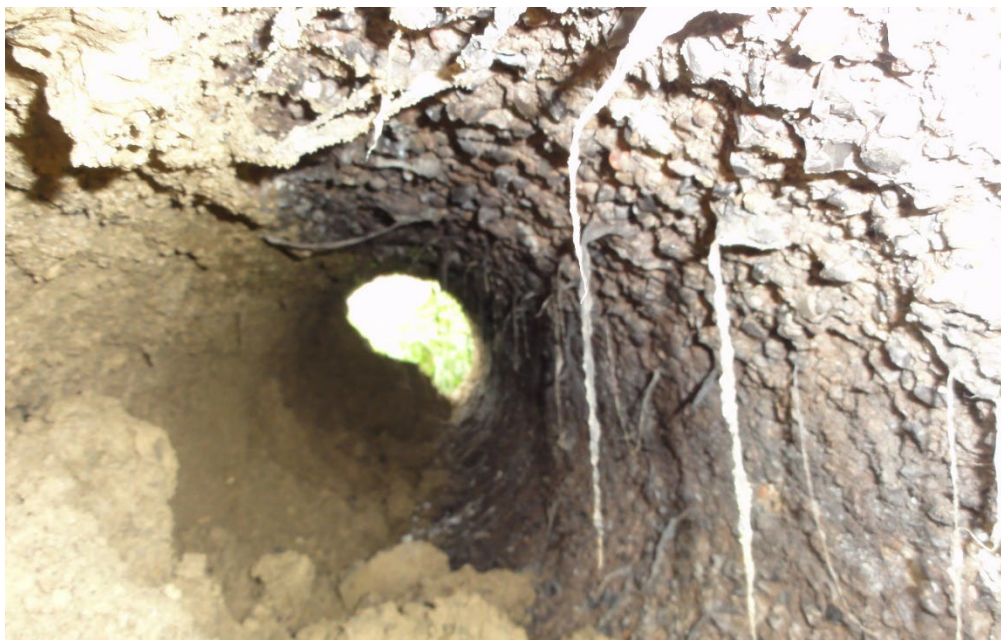
Figur 50. Billeder af gammelt rør fra rørstrækning anlagt i Frejlev i 1980.
