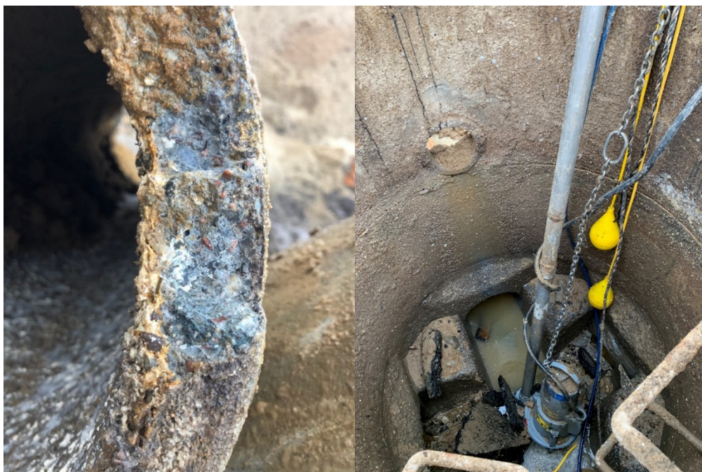
Figur 62. Billede af gammel rør og brønd fra rørstrækning i Bjerre etableret i 1967.
