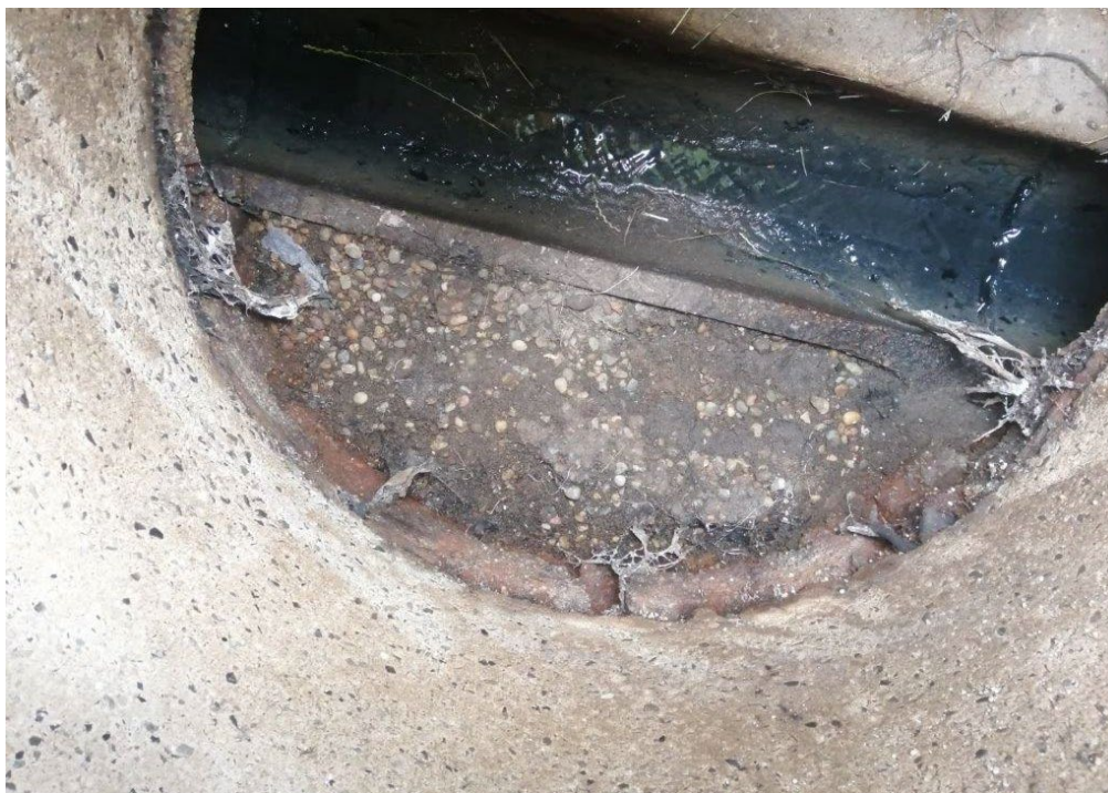
Figur 54. Billede af gammel brønd på Porsholtparken. Alderen ved udskiftning er ukendt.
