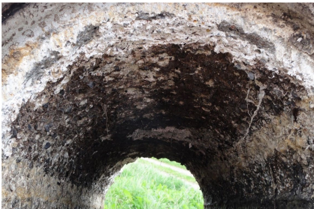
Figur 49. Billeder af gammelt rør fra rørstrækning anlagt i Frejlev i 1980.
