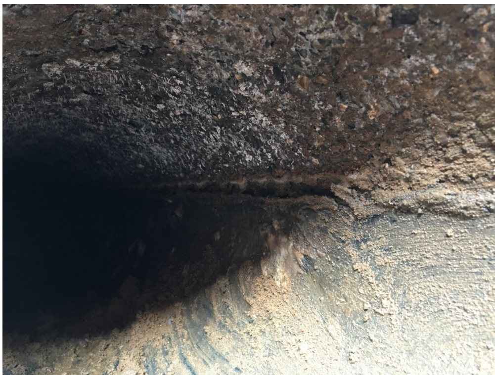
Figur 59. Billede af gammelt rør fra rørstrækning anlagt i Fredericia.
