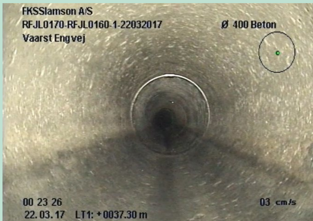
FIGUR 2. Billeder fra TV-inspektion af rørstrækning udlagt ifm. rørprojekt I
