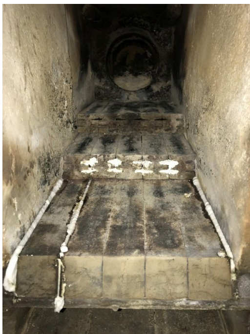
REKA-kedel 30 kW indvendigt. Der er lavet tilpasninger af kedlens lufttilførslen for at sikre, at brændslet kan afbrændes og luften tilsættes det korrekte sted. (Foto: Anders Pødenphant, Teknologisk Institut).
