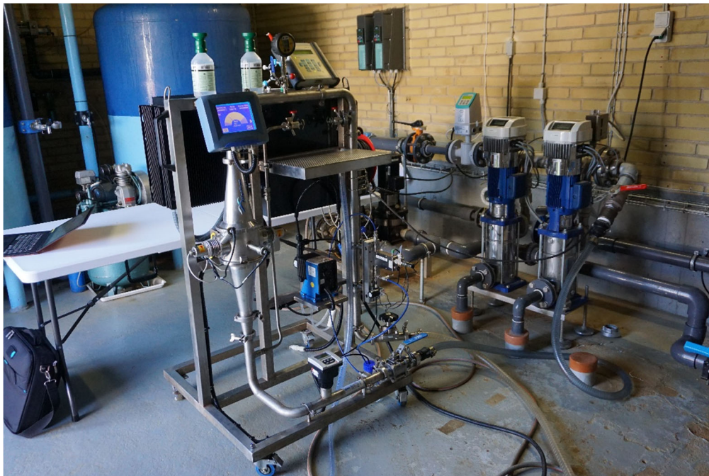
Pilotanlæg under test ved Langebæk Vandværk
