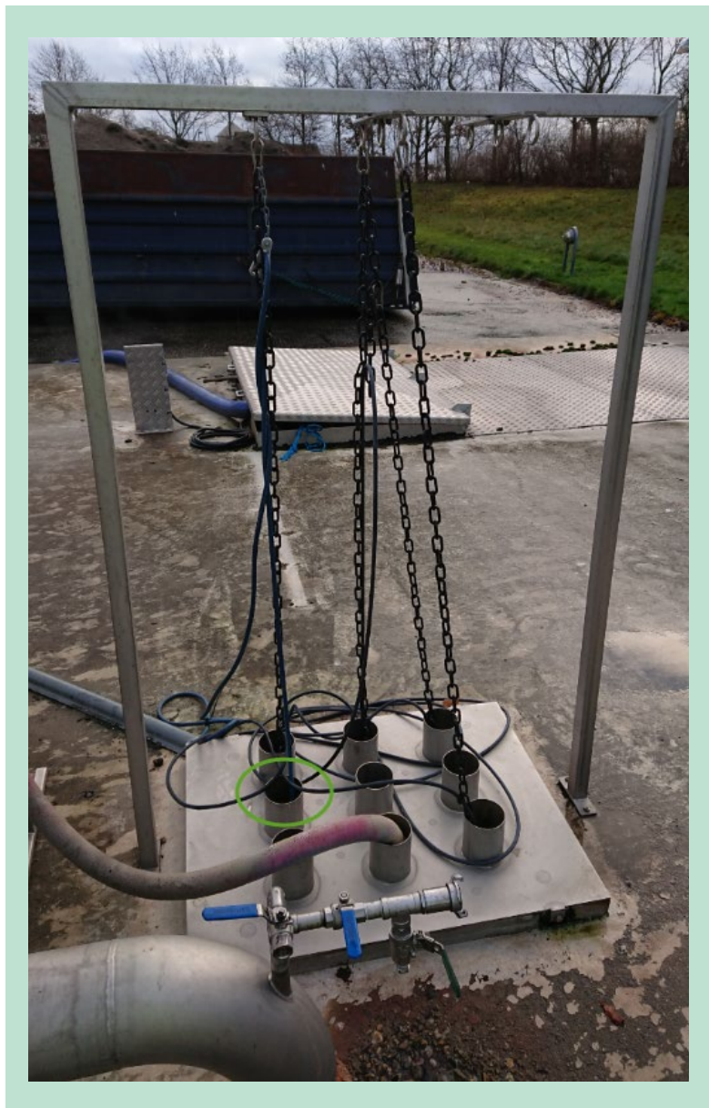
FIGUR 8. DEMON®-anlægget på Marselisborg er etableret i to ældre, nedgravede kemikalietanke. På billedet ses sensorplacering og N 2 O sensoren er markeret med en grøn cirkel.
