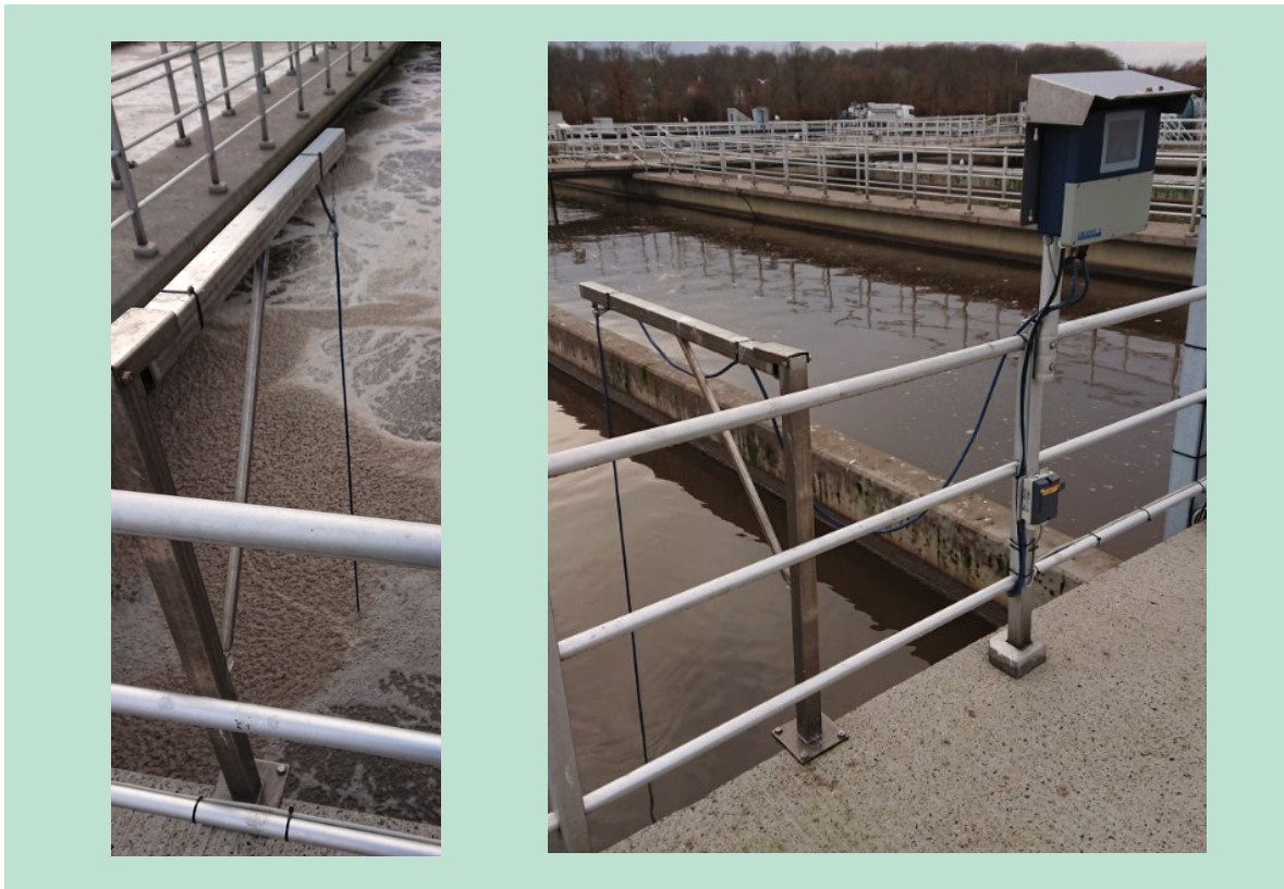
FIGUR 6. TH: N 2 O sensor i PT1. sensoren er neddykket ca. 30 cm under overfladen. TV: N 2 O sensor i PT3. Sensoren er neddykket ca. 30 cm under overfladen. På billedet ses også controlleren begge sensorer er koblet på.
