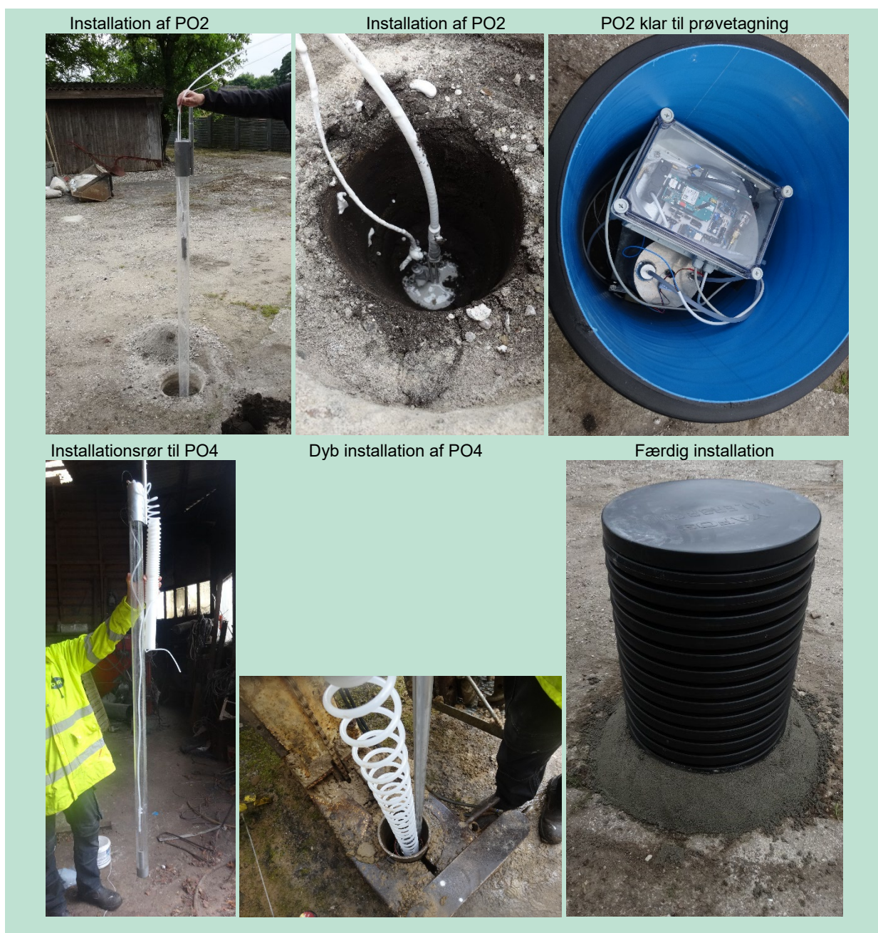
FIGUR 9.5. Fotos fra installation af sugeceller.
