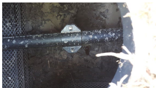
Slamlag i rum 3 i anlæg med excentersnekkepumpe. Foto: Peder S. Gregersen, maj 2018
