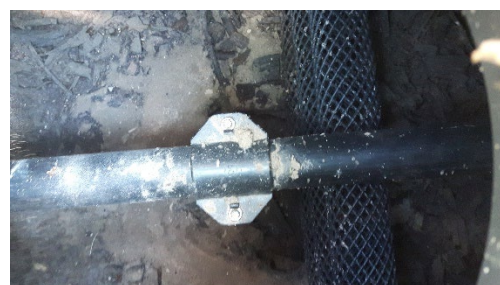
Slamlag i rum 6 i anlæg med excentersnekkepumpe. Foto: Peder S. Gregersen, maj 2018
