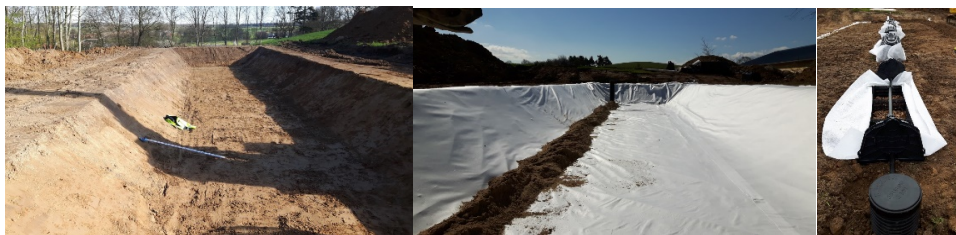
Etablering af pileanlæg med fordelingsystem til slam sammen med spildevandet. Foto: Peder S. Gregersen, april 2018
