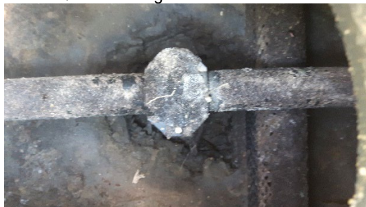
Slamlag i rum 1 (syd fra) i anlæg med excentersnekkepumpe. Foto: Peder S. Gregersen, maj 2018
