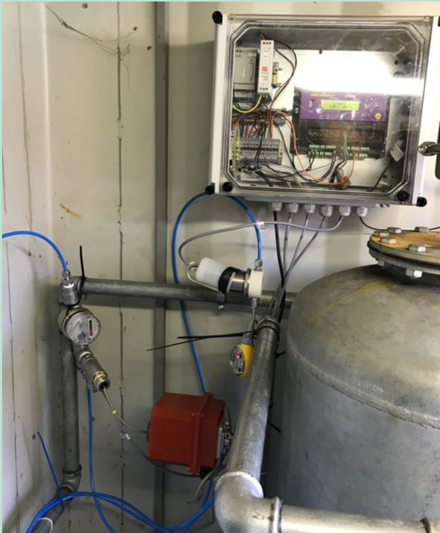
FIGUR 22. Installationen på lokation 2. Den røde boks er trevejsventilen, hvorpå en flow-switch (gul) er monteret. Dernæst sidder sensorholderen version 1 (med hvid plast-beskyttelseshætte). Med den blå slange forbindes denne til sensorholderen version 2, som sidder direkte på et vandur. De to sensorversioner sidder således serielt og måler på samme vandstrøm.
