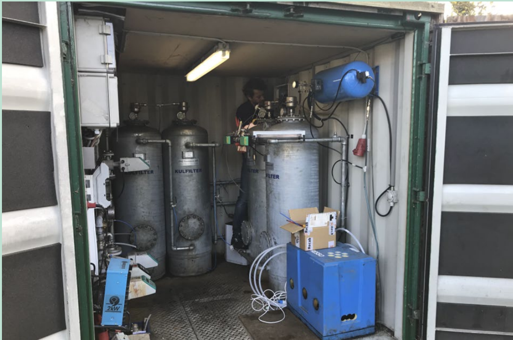
FIGUR 21. Afværgeanlægget på lokation 2.
