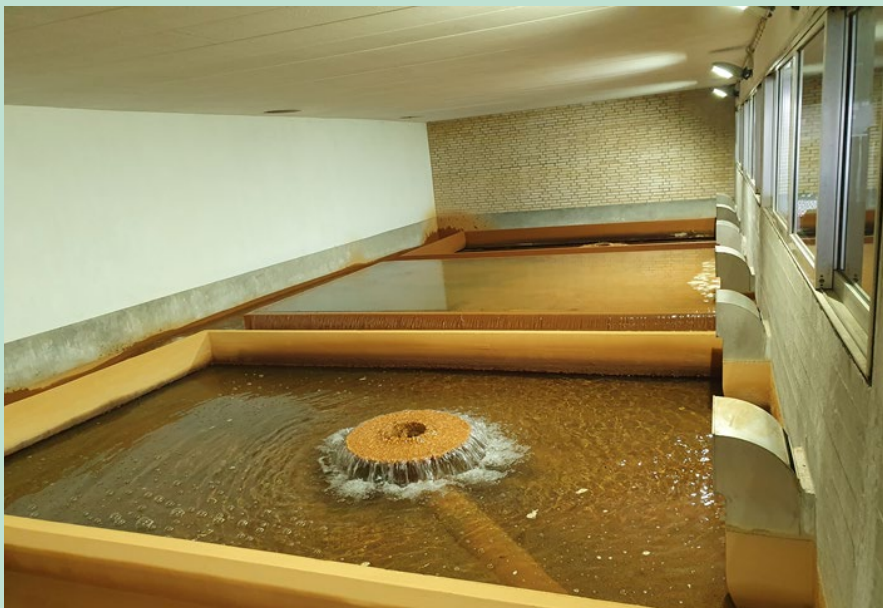
FIGUR 27. Forfiltrene på Højballegård Vandværk i Horsens. Grundvandet i rørene tilsættes ren ilt, hvorved metan afgasser over sandfiltrene i rummet.
