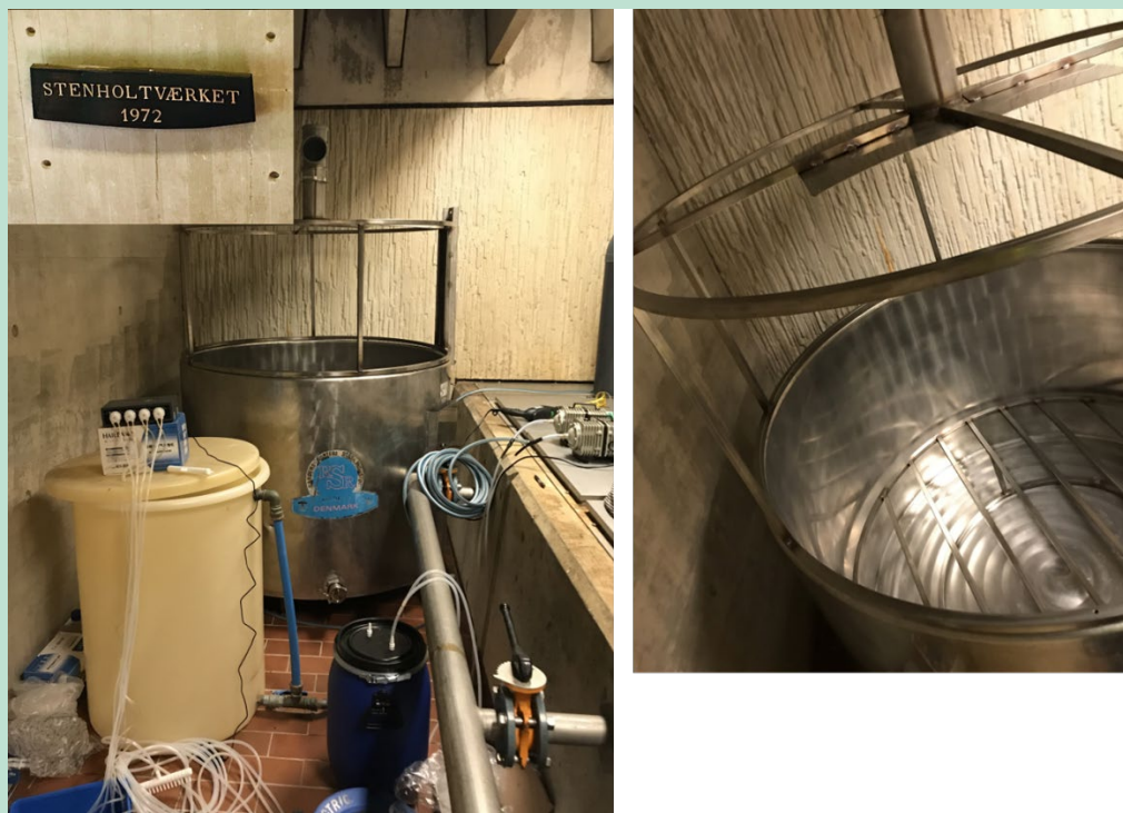
FIGUR 18. Opbygning af BioBox'en i fuldskala på Stenholtværket i Hillerød. Metalnettet blev konstrueret for at fastholde matricen i BioBox'en. Den gule tønde indeholdt vand beriget med NPK og kobber. Blå tønde (sort låg) med zinkacetat anvendtes til udfældning af H_2S fra luften.
