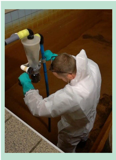
FIGUR 4. Proton Pack under prøvetagning af filtermedie i drænet filter. Det ses, hvordan filter-sandet slynges rundt i hydrocyklonen og ender i glasflasken, når der tilsluttes vakuum via støvsugeren koblet med støvsugerslangen til hydrocyklonens top.
