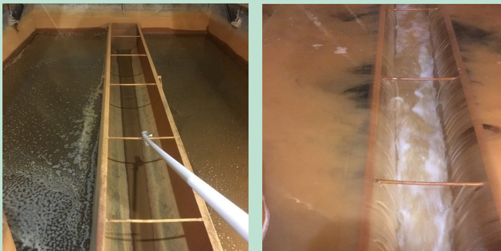
FIGUR 7. Billeder af skyllerenden lige inden prøvetagning (tv) og skyllevandet, der løber i skyllerenden (th), Lundeværket.
