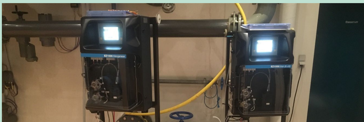
FIGUR 9. Til højre på billedet ses EZ1000 jernmåleren opstillet på vandværket, hvor den måler jernkoncentrationen skiftevis i råvand og udløb fra filter. Til venstre ses manganmåleren.
