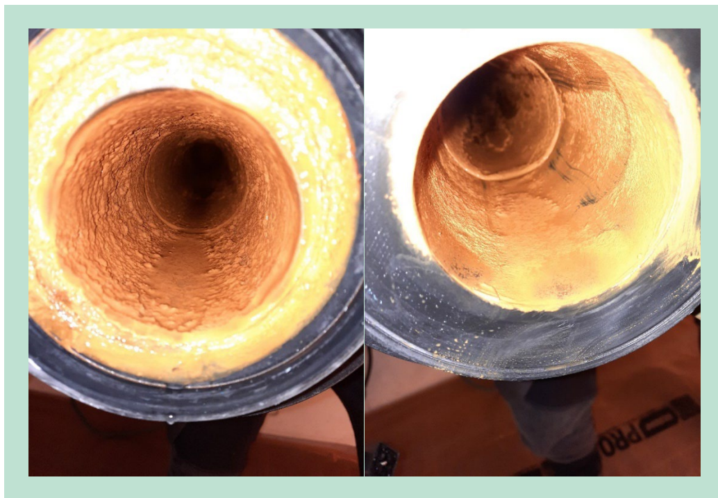
FIGUR 17. Udfældninger af jern i rørføring mellem iltning og forsøgsfilter før og efter rensning.
