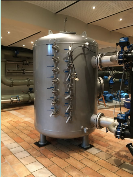
FIGUR 2. Efterfilter med prøvetagningsventiler og manometre påmonteret.
