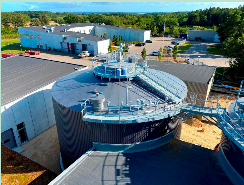
FIGUR 9. Gastæt slamlagertank med opsamling af biogas.
