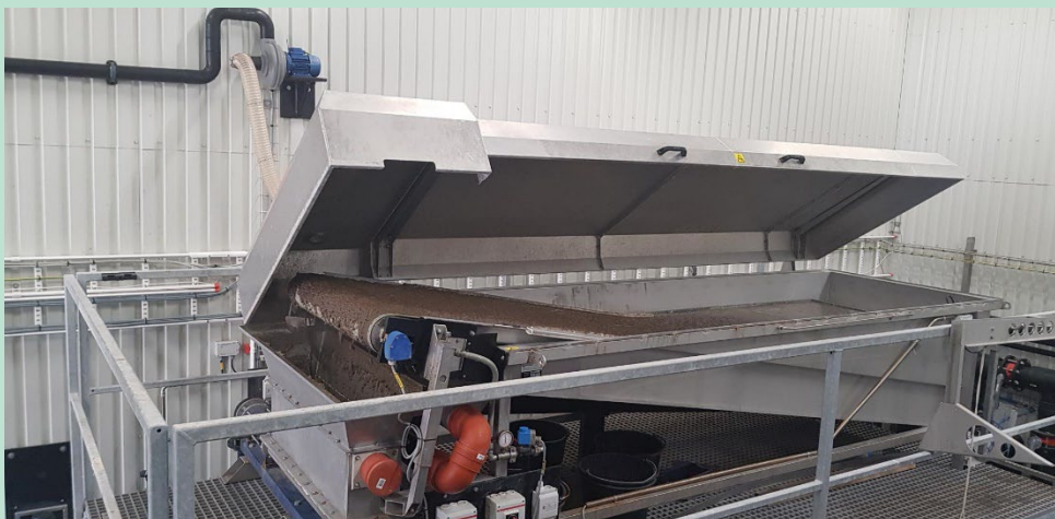
FIGUR 3. Båndfilter på Sashimi Royal, som fjerner slam fra afløbsvandet.
