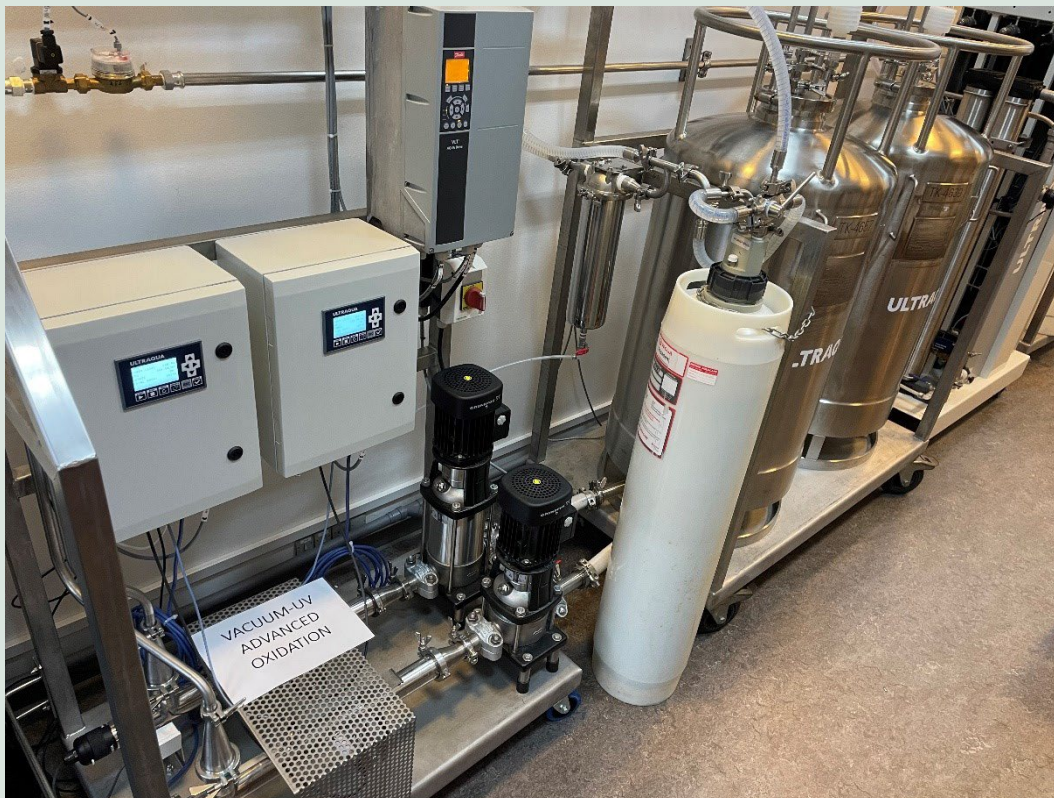
FIGUR 7-3. Poleringsdelen af anlægget til produktion af Purified Water med: UV til desinfektion, Vacuum-UV til avanceret oxidation og ionbytterkolonne til sikring af den lave ledningsevne er vist på foto.
