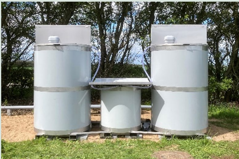
FIGUR 9. Biofilter til rensning af kloakluft ved testlokation Sanatorievej i Stouby.
