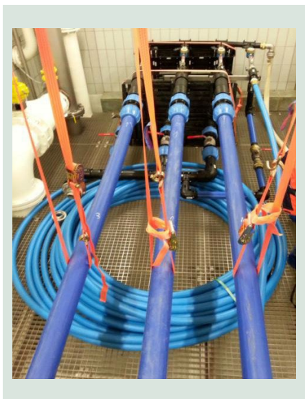
FIGUR 7. Opstillingen viser testriggen med de tre PEM rør, G1, G2 og G3, samt den nye PE-rulle synlig under disse.
