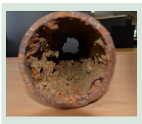
FIGUR 14. Støbejernsledning (Ringkøbingvej) før Ice Pigging.
