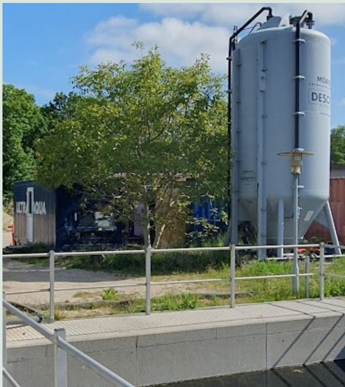
FIGUR 8-3. Foto af GAC-filter placeret ved siden af pilotcontainerne.
