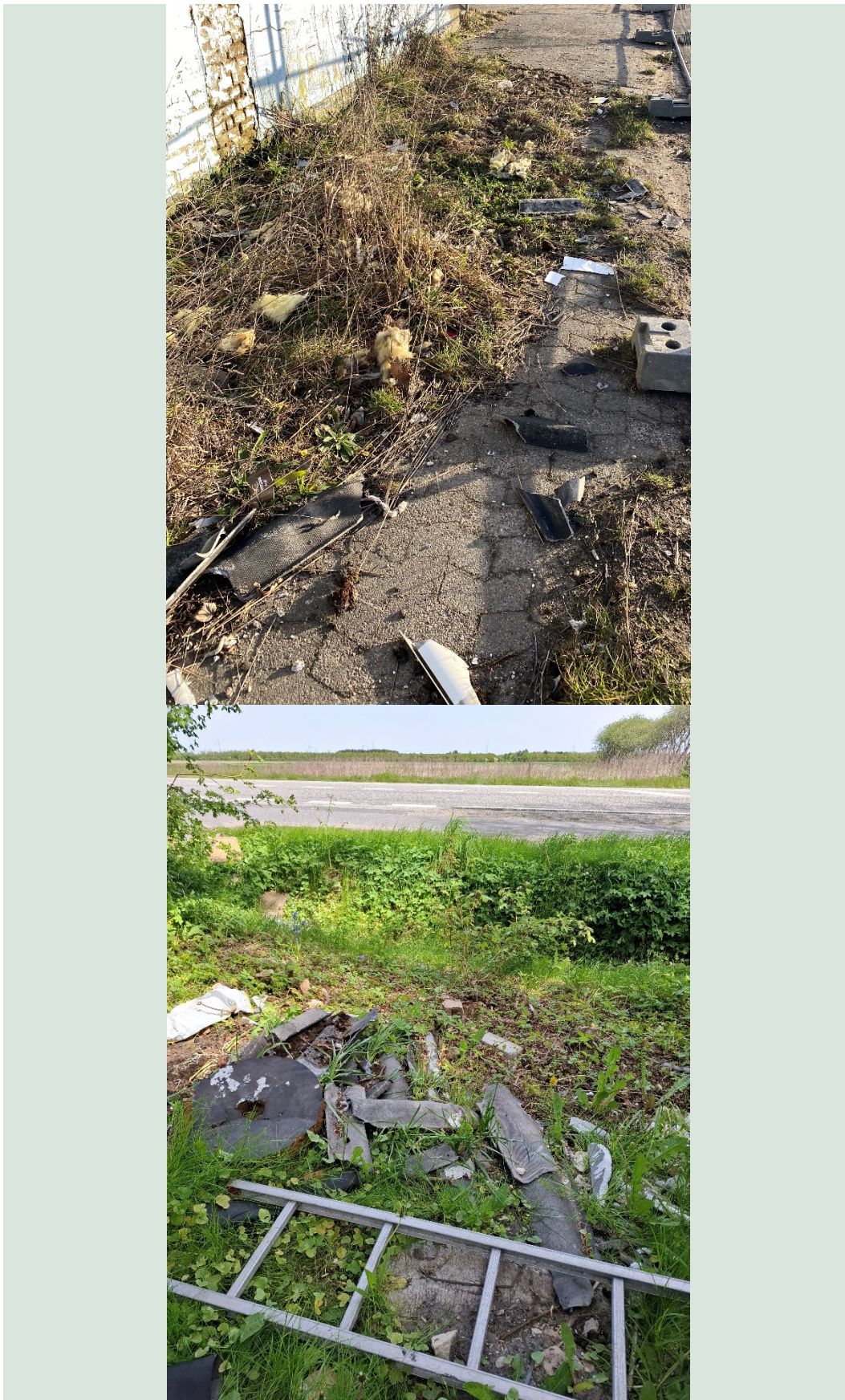
FIGUR 1. Eksempler på asbestholdigt materiale, der er blevet spredt ved en nedrivning/renovering. Billeder er fra Aalborg kommune.
