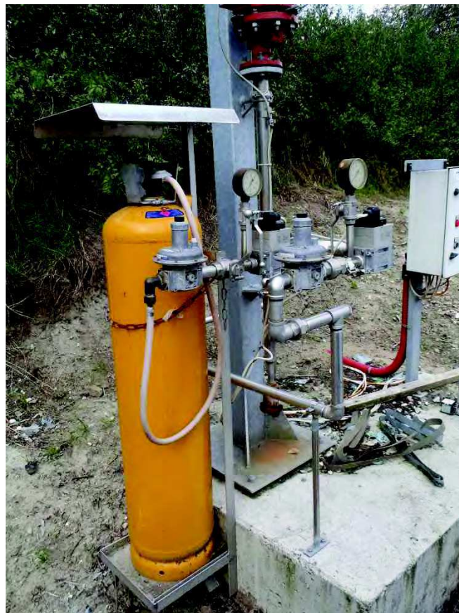
Foto 12: Affaklingsanlæg. Den gule gasflaske indeholder støttebrændsel.
