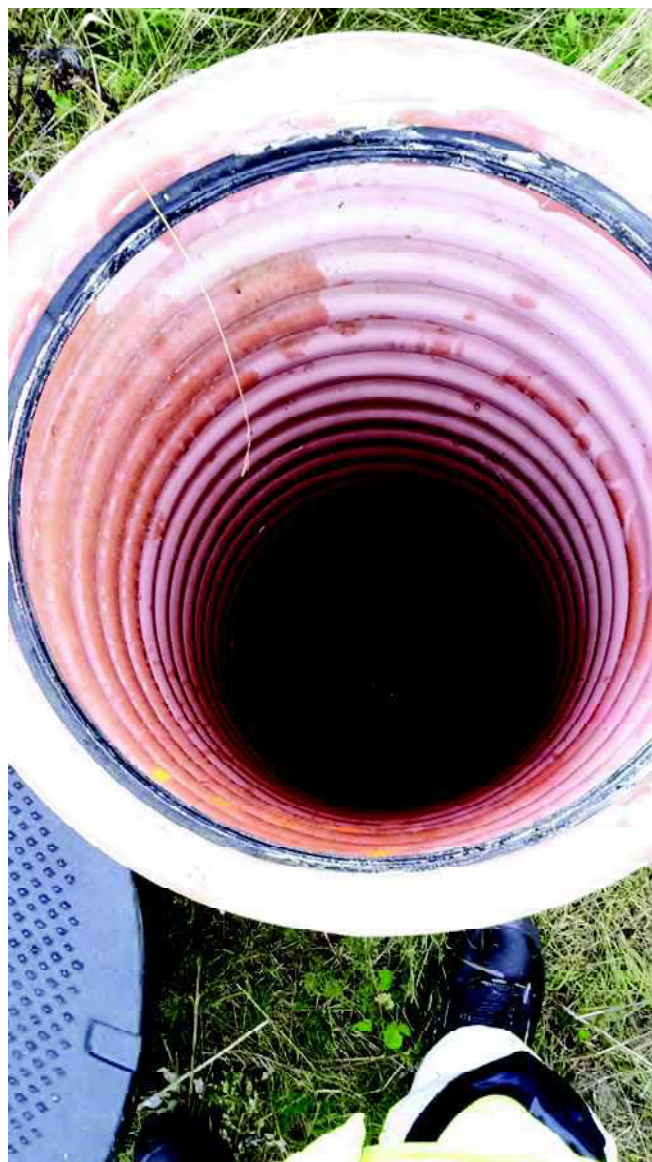
Foto 8: Gasindvindingsboring PB7 afsluttet under terræn.
