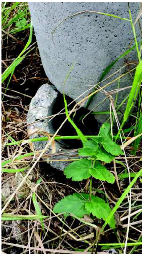
Foto 14: Brud på boring B208.
