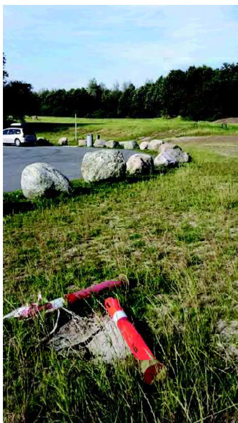
Foto 5: Område J med knækket brønddæksel i forgrunden.
