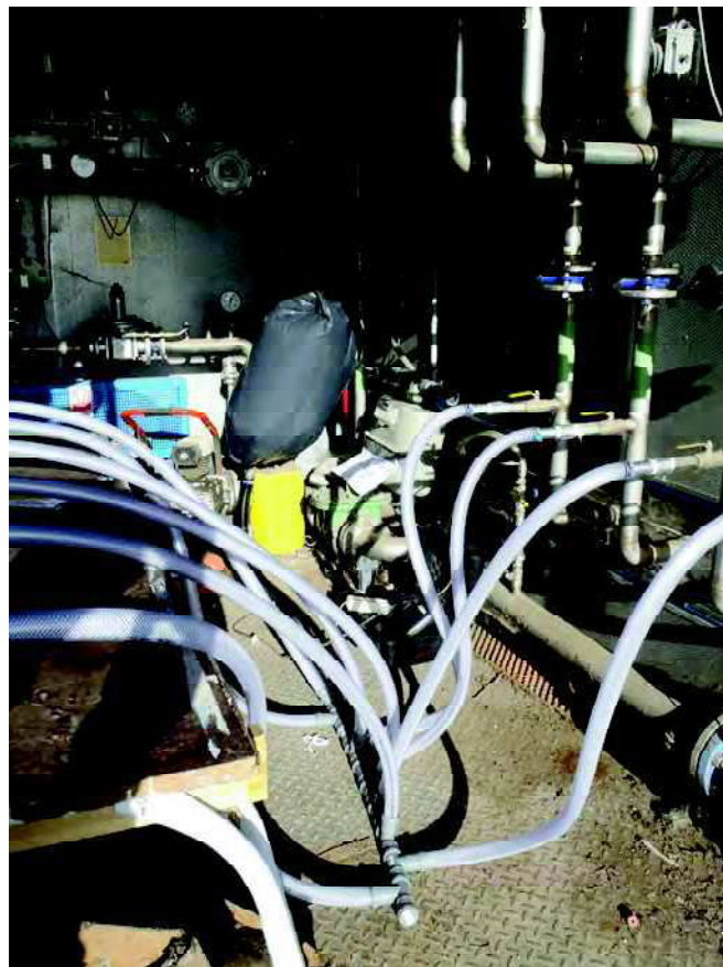
Foto 20: "Posemåling" på samlet afkast fra manifold under passive forhold.
