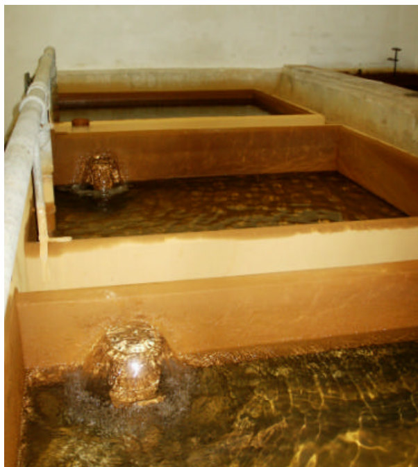
Figur 6. Filtre i drift, Elmevej Vandværk.
