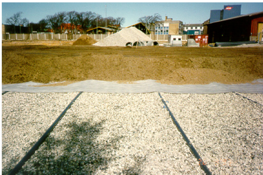
Figur 2.6: Infiltrationsanlægget på Hjørring Gasværk. Nøddestenslag, infiltrationsstrenge, geotekstil samt overliggende råjord.
