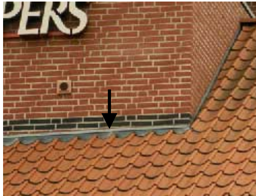
Figur 9 Vandret sammenskæring mellem mur og tagflade (markeret med pilen). Øverst til højre ses en skrå sammenskæring med siderende (afsn. 2.1)
