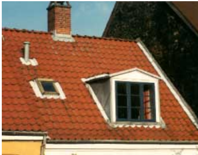
Figur 1. Eksempel på inddækning med bly ved skorsten, ventilationshætte, ovenlysvindue, kvist og tilstødende gavl.
