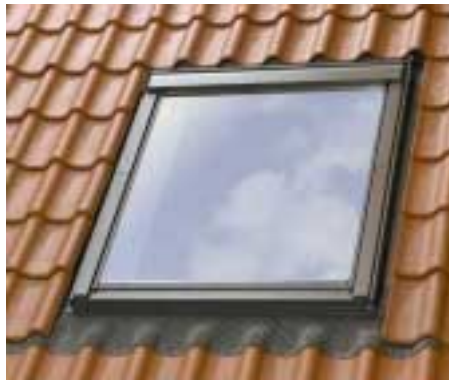
Figur 23. Inddækning af et ovenlysvindue med blyfri standardinddækning. Bemærk den skjulte siderende på de 3 sider og forkantstykket af plisseret aluminium.
