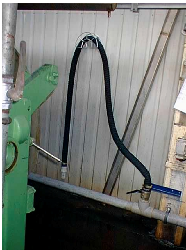
Figur 15: Slange- og rørarrangement til at pumpe vand fra jiggerne til opsamlingstanken.
