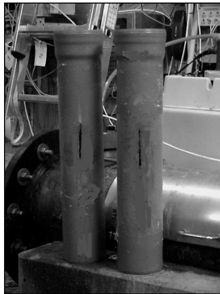
Foto 4-6: Kunstige revner i bunden af ø110 PVC-rør.
