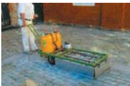
På svært tilgængelige arealer kan fugerne forsegles med et plastisk materiale, der smeltes ned i fugerne.
