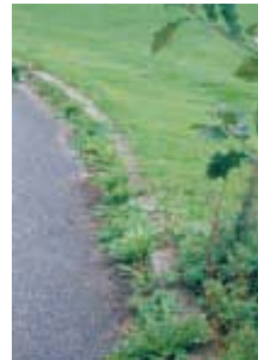
Ukrudt langs kantsten kan betyde at der trænger vand ned i asfalten, som kan give frostsprængninger og forkorte belægningens levetid. Det kan også forhindre regnvand i at løbe hen til risten. Vandet vil i stedet samle sig i store vandpytter.
