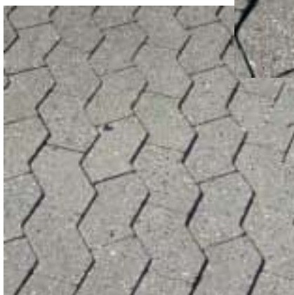
Ukrudtet har gode vilkår, hvis fugerne ikke er fyldt op med fugemateriale.
