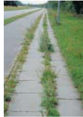
Ukrudt i fugerne kan genere færdslen og presse fliser og belægningssten fra hinanden. Når fugerne bliver bredere, kan der trænge vand ned i bærelaget. Det kan give sætninger og opfrysninger, så belægningerne bliver ujævne og farlige at færdes på.
