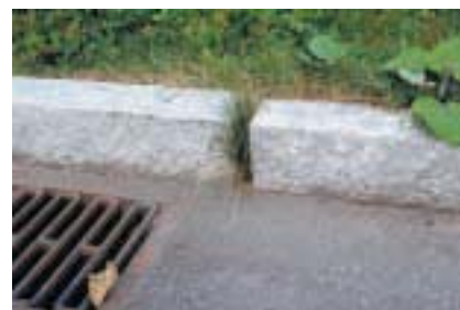
Ved at tætte fugerne mellem de enkelte moduler i kantstenen, kunne man have hindret ukrudtet i at gro ind i asfalten.
