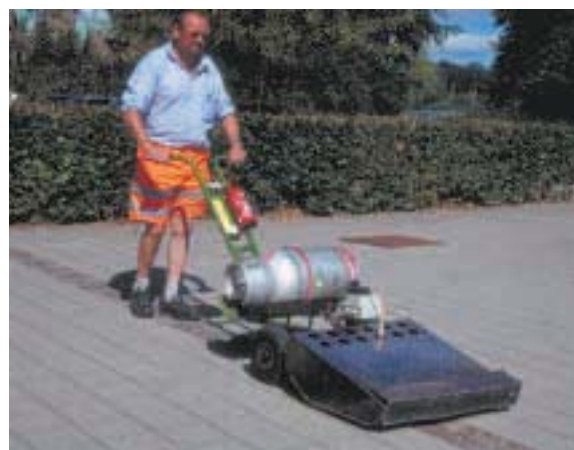
Tilstandskrav kontrolleres før behandling og udførelseskrav efter.
