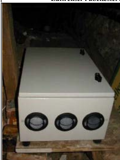
Udblæsningsdyser rettet ud i lokalet
