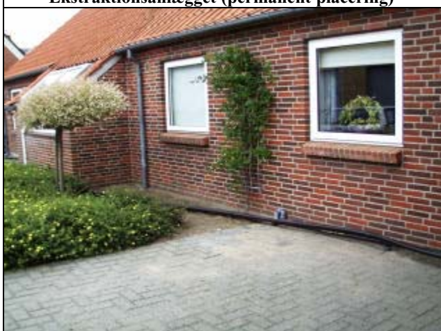
Rørføring og luftindtag (svane Hals)
