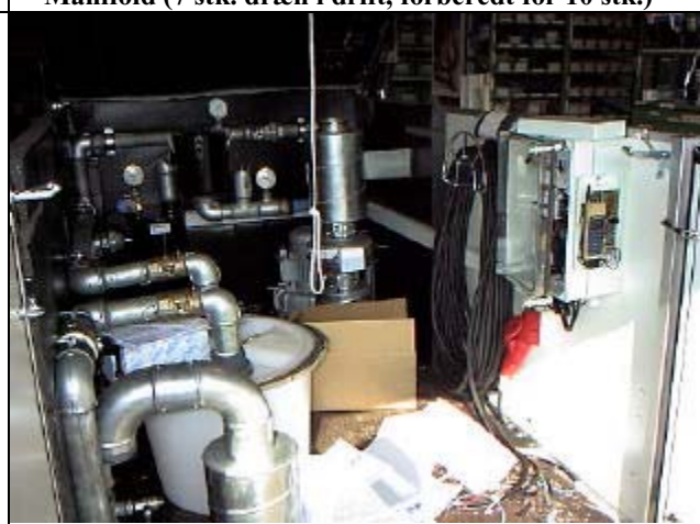
Kulfilter, vakuumpumpe, SRO mv.
