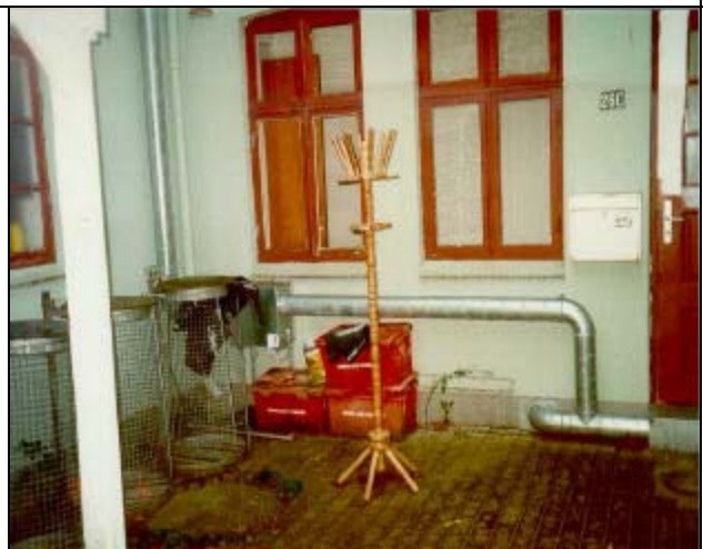
Lyddæmpet boks med ventilator (udvendig på bygningen).
