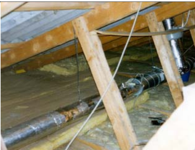
Afkastrør og ventilator ført under tag
