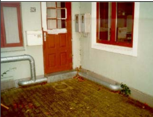
Udvendig overjordisk rørføring (stålrør).
