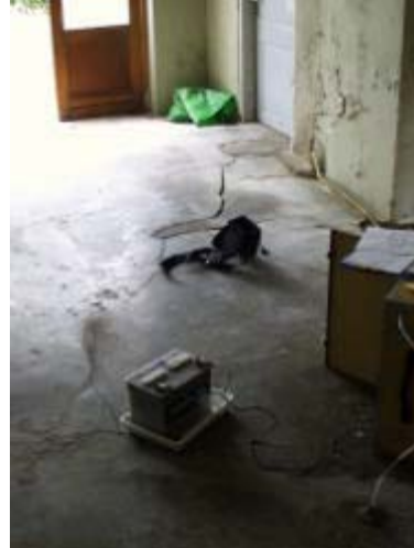
Kraftige revner i eksisterende gulv
