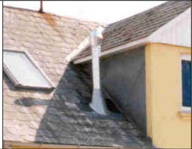
Afkast fra ventilator
