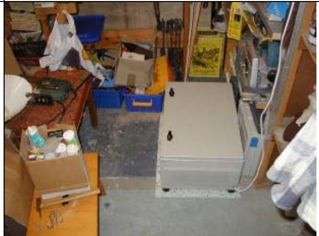
Luftrensner i befæstet kælder
