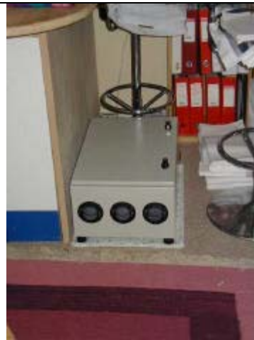
Udblæsningsdyser rettet ud i lokalet
