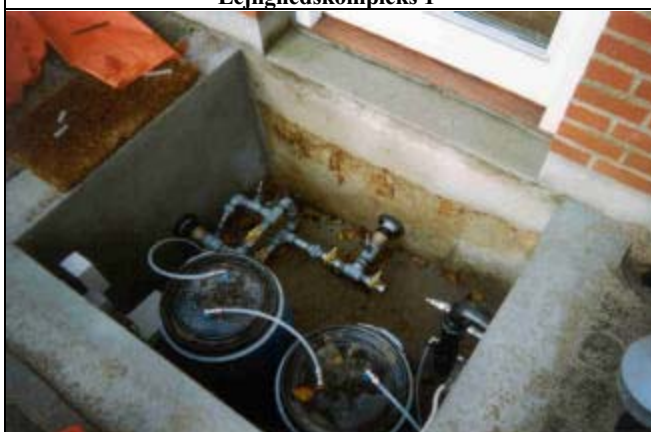
Teknikkase rørføring og kulfilter
