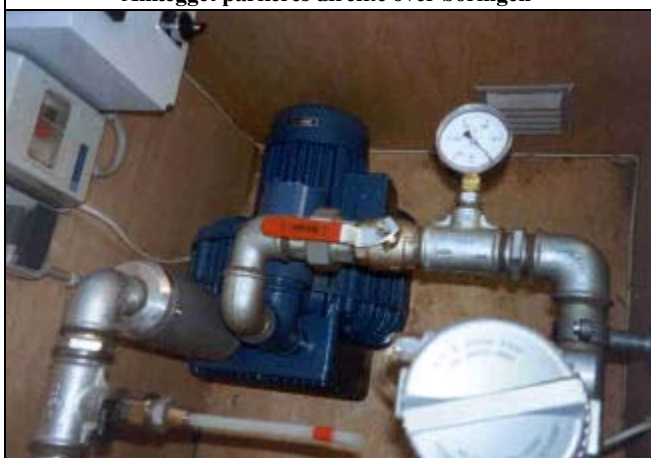
Vakuumpumpe, flowmåler mv.
