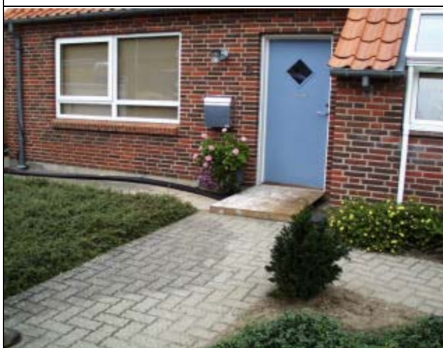
Overjordisk rørføring (passage v. hoveddøren)
