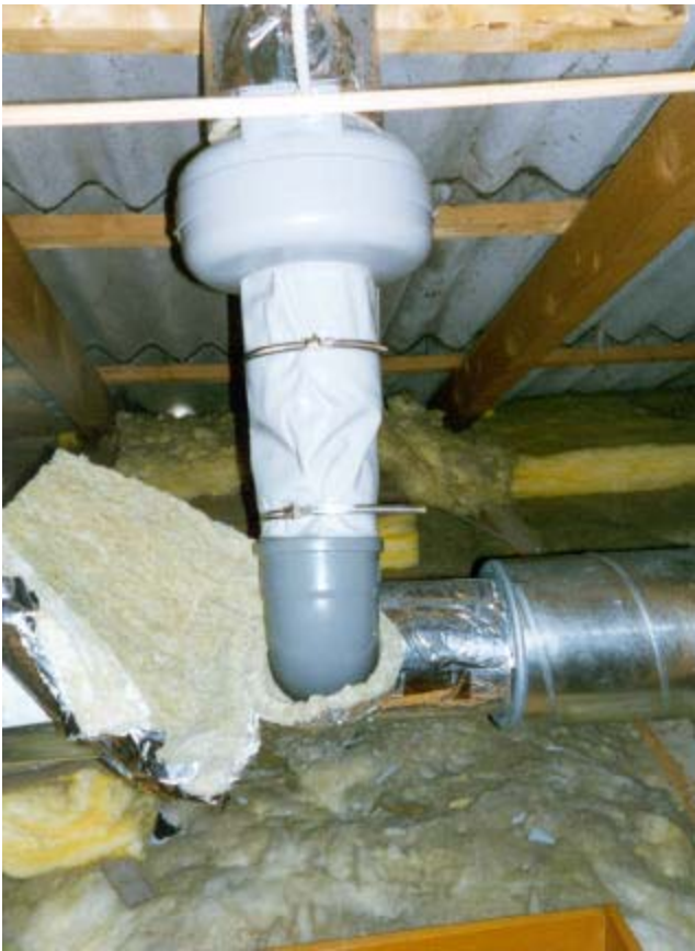
Ventilator på loftsrum
