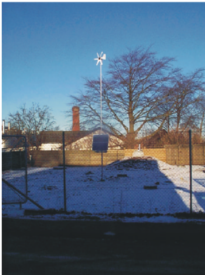
Figur 4.5 Solcelle og vindmølle placeret på stålmast. I baggrunden ses samlebrønden hvor kulfiltret er monteret. Nygade 37, Fakse.
