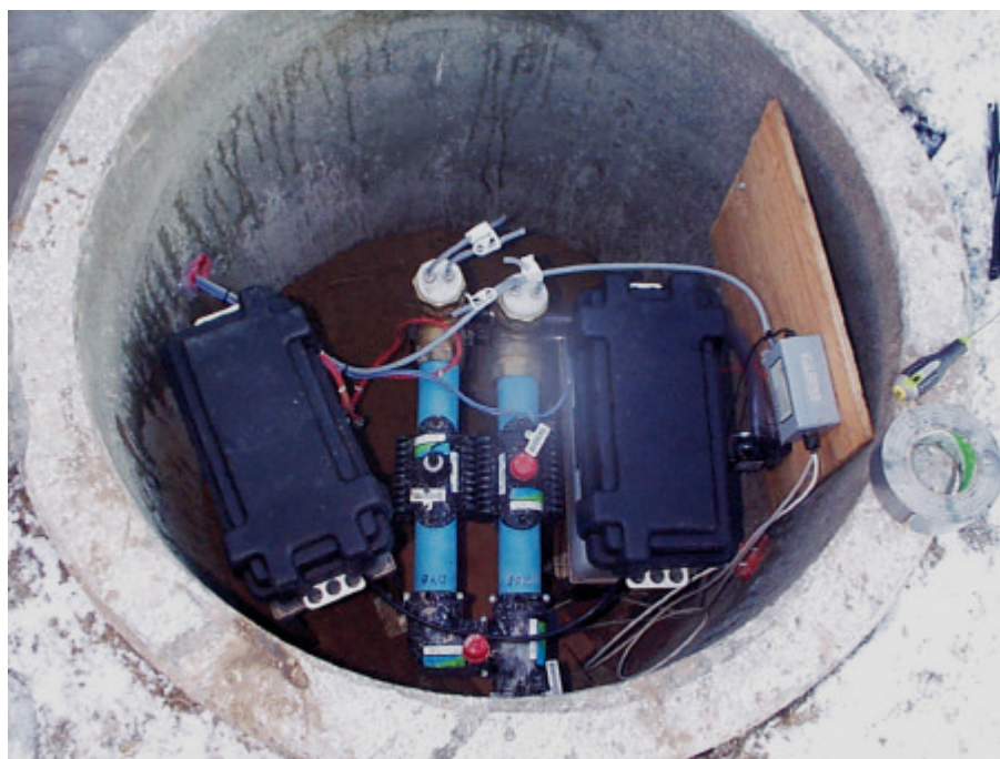
Figur 4.6 Mini vakuumpumpen (sort) ses under den grå box til højre i billedet. De to blå rør er tilkoblet filtrene for hhv. sandlaget og kalken. Nygade 37, Fakse.
