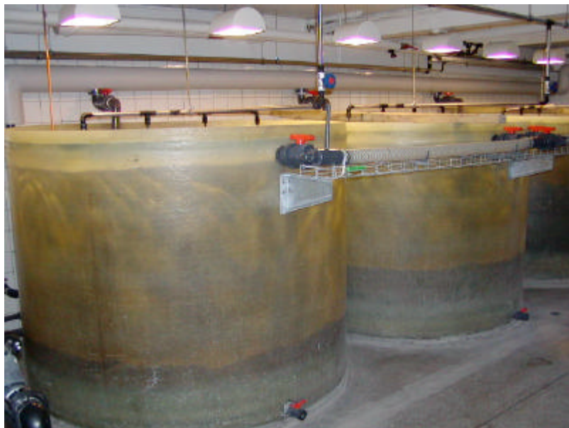
Behandlingstanke i kælderen
