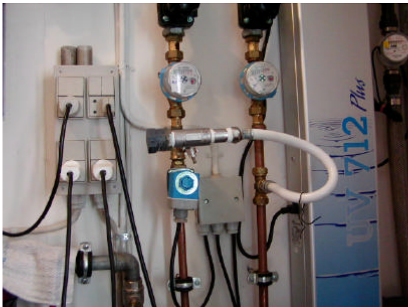
Sløjfe fra vandsværvand til gråvands anlægget
