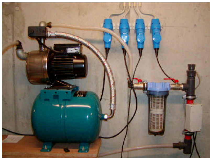
Trykpumpe, patronfilter og UV-filter
