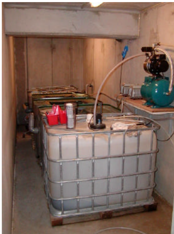
Figur 21: Gråvandsanlæg, Virklung Afd. 42
