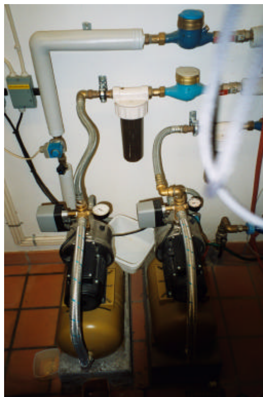
Regnvandsanlæg (venstre) og Grävandsanlæg (højre)
