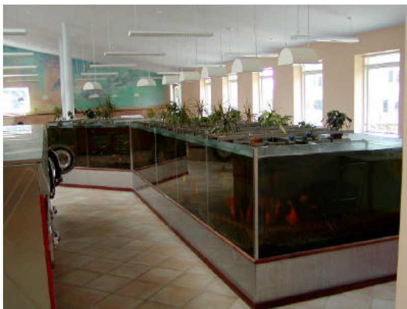
Figur 16: Gråvandsanlægget Folehaven, behandlingsakvarium
