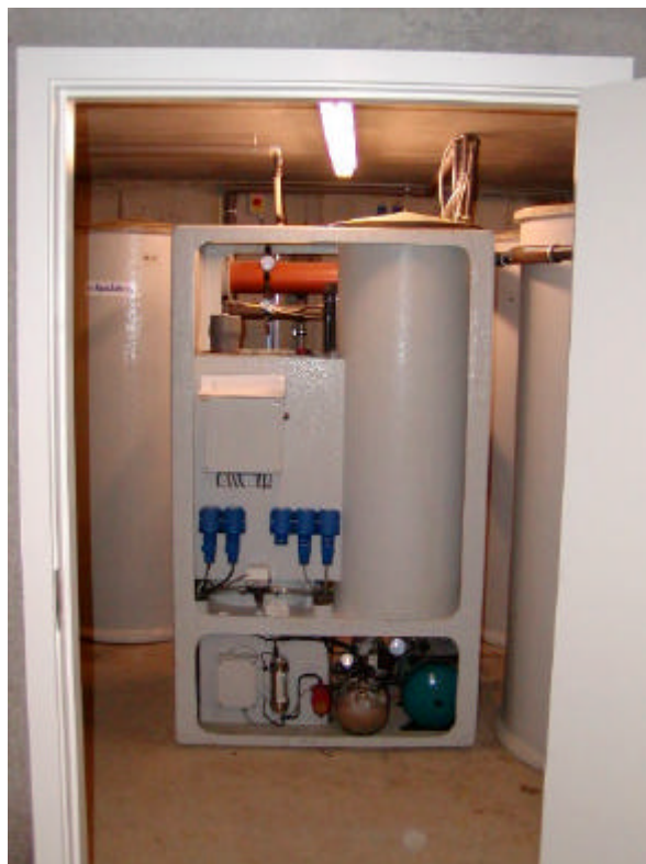
Figur 25: Gråvandsanlæg, Virklund Afd. 47
