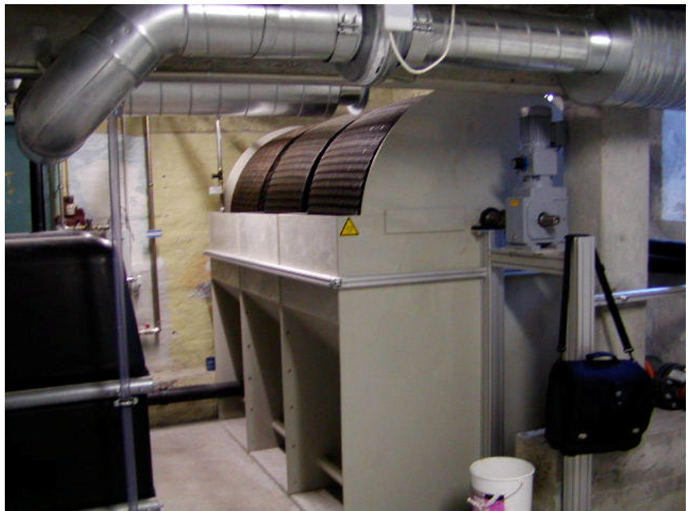
Figur 27: Biofil teranlægget ved Gråvandsanlæg, Nordhavnsgården
