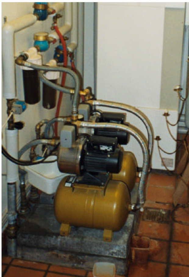
Figur 23: Regnvands- og gråvandsanlæg, LEV-Huset, Pile allé 10
