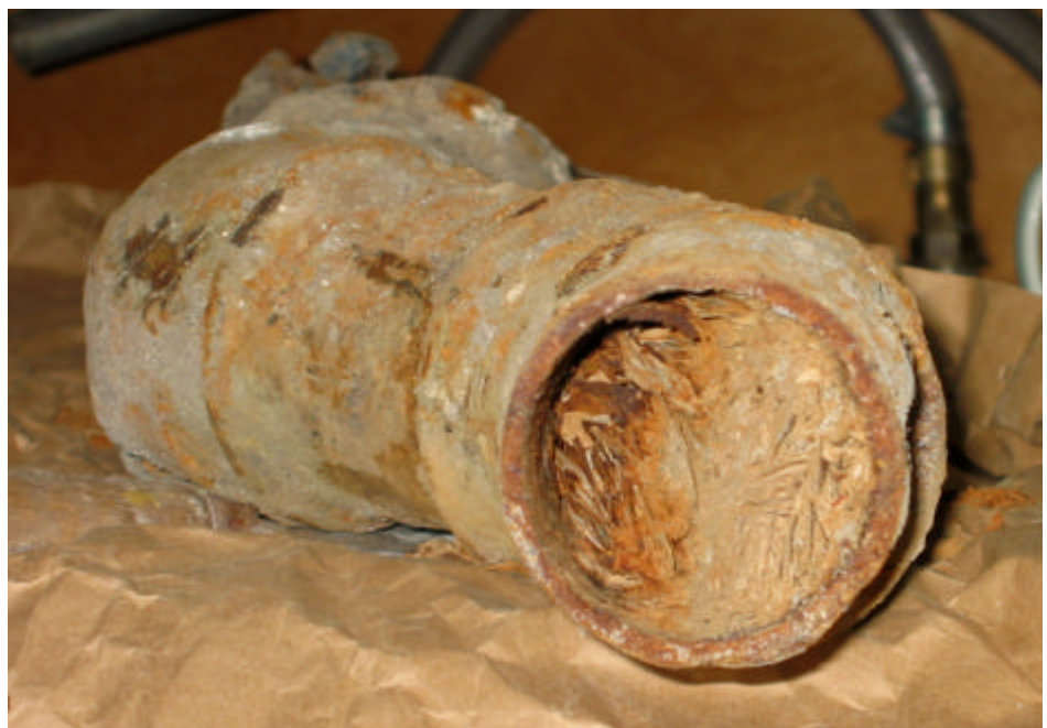
Figur 3.7 Et opgravet rør efter omrensning i område III. Heri ses belægninger af jern, kalk og finkornet sediment i en sådan grad, at lysningen i røret var helt lukket
