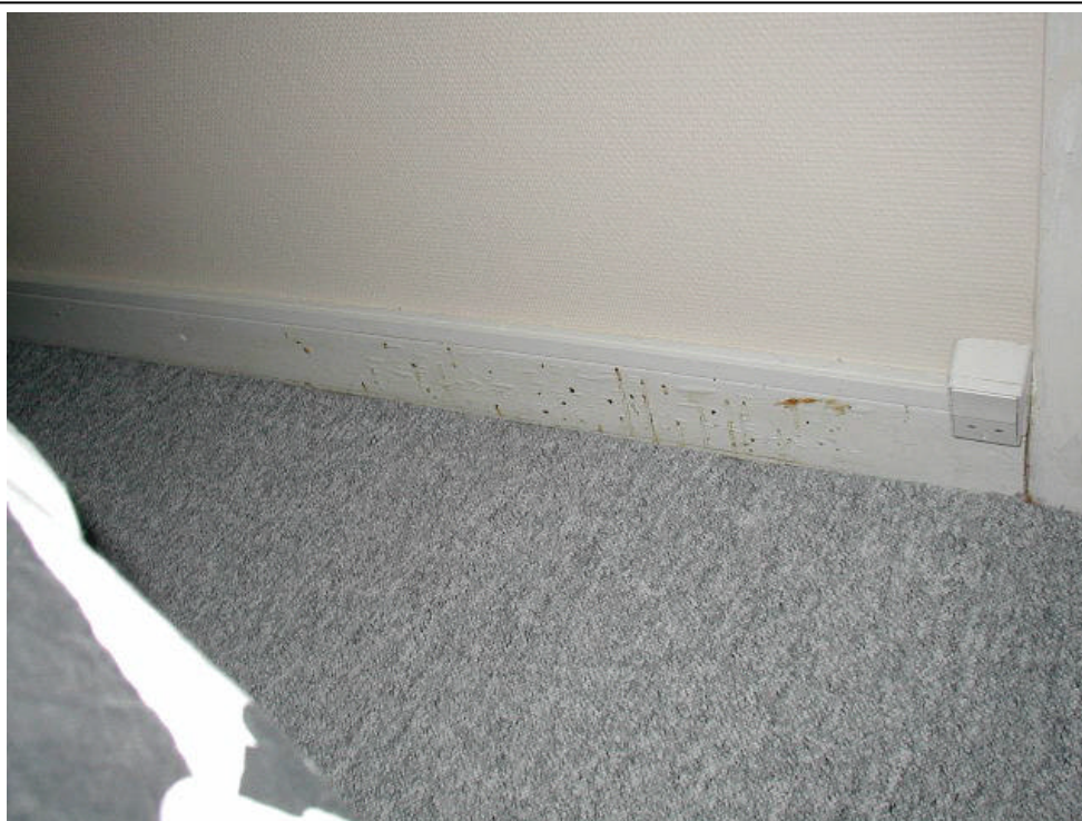
Figur 3.14 Fugt og misfarvning i fodpaneler
