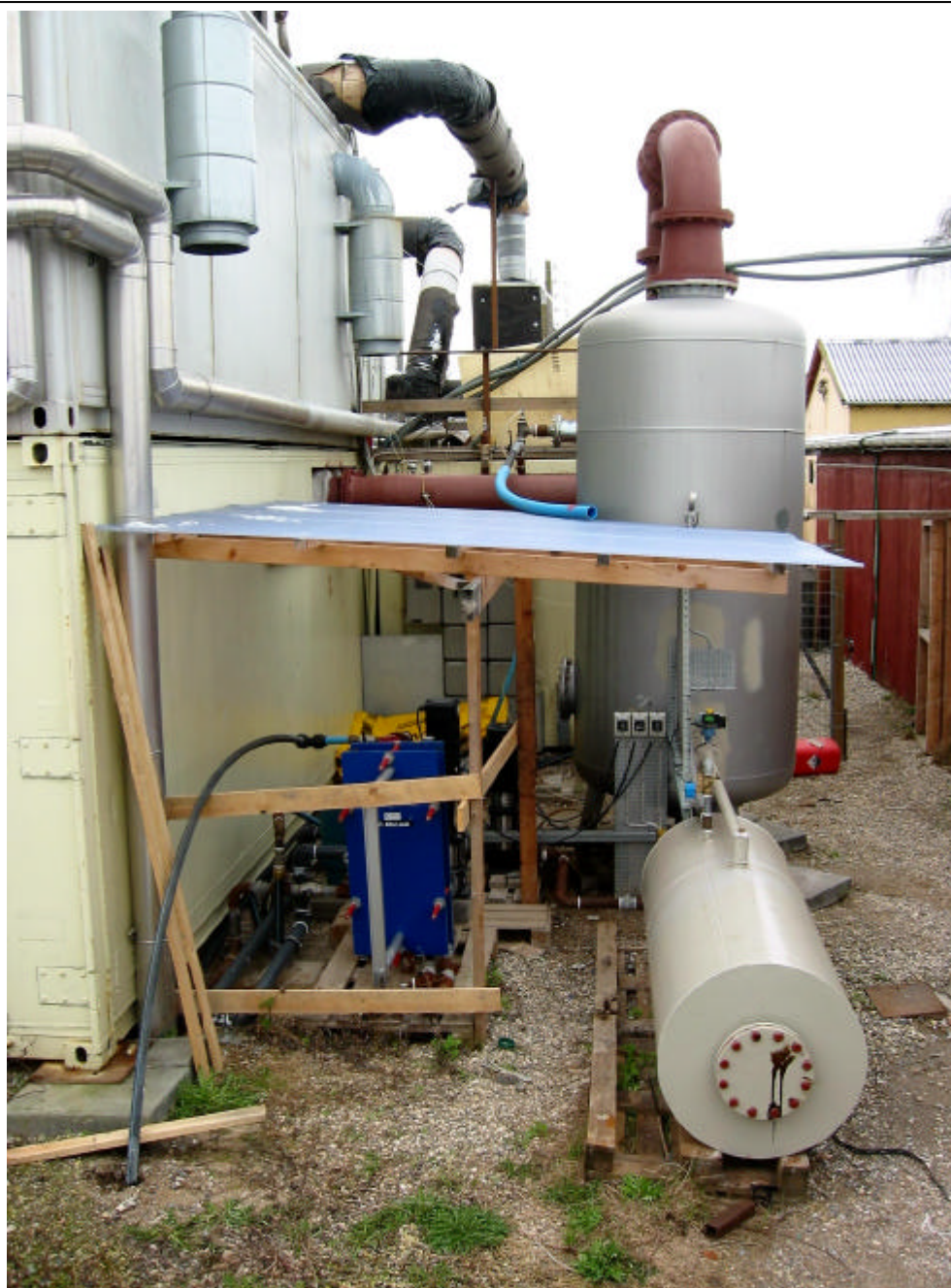
Figur 3.8 Cyklonen står til højre med indløb i toppen, vandudskilleren ligger til højre og under halvtaget ses en ekstra vandkøler.
