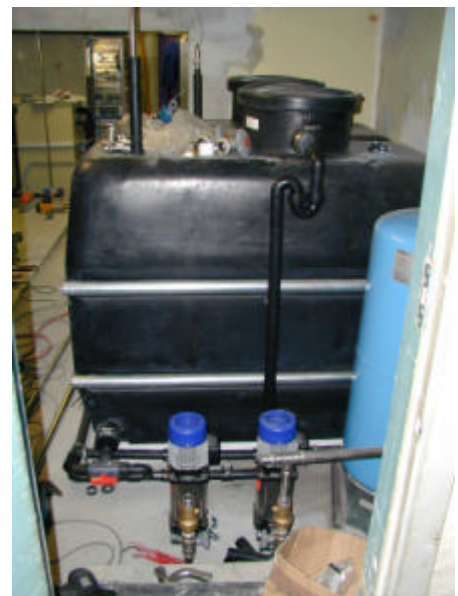
Figur 2.12: Opbevaringstanke og trykpumper
