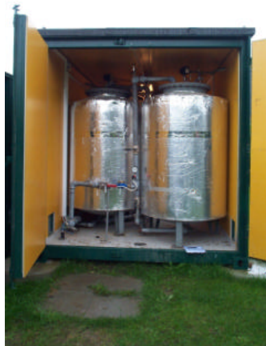
Figur 17 De isolerede jernspånefiltre ved Lyndby Rens.
