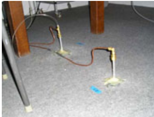
Tv: Indendørs poreluftsonde Th: perforeret alu-sonde
