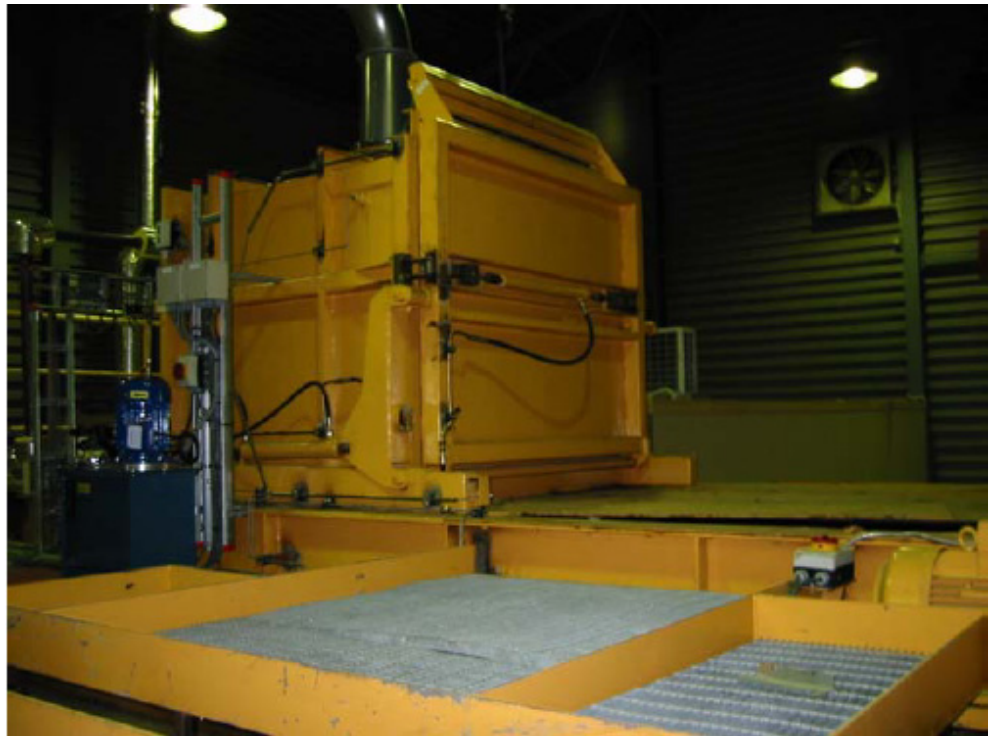
Figur 1. Lier Fjernvarme: Indfødningsluse oven på forgasningskammer.
