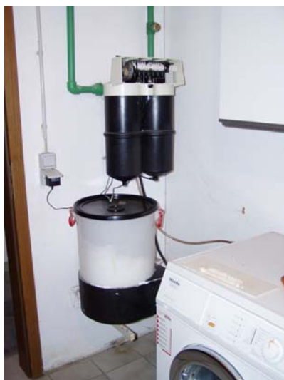
Figur 3. Ionbyttere for nitratreduktion på stor gård. Bemærk at dækslet på toppen af ionbytterne er demonteret for at vise "flowtæller-styringen". Nederst ses saltlageret.
