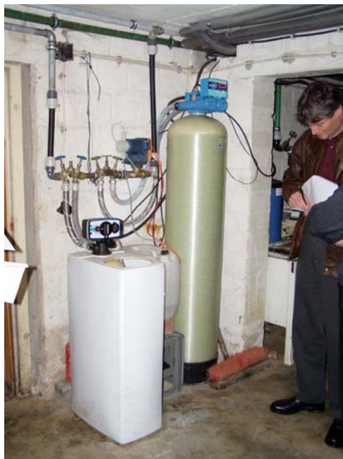
Figur 4. Ionbytter for nitratreduktion på landcafé. Forbehandling: Dunk med natriumhydroxid i midten og greensandfilter til højre. Til venstre skimtes toppen af ionbytteren som er placeret i saltlageret.
