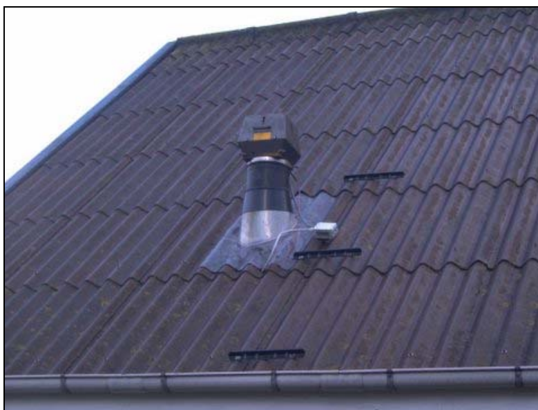
Figur 28. Eksempel 8: Røgsuger monteret på den alt for lave skorsten.
