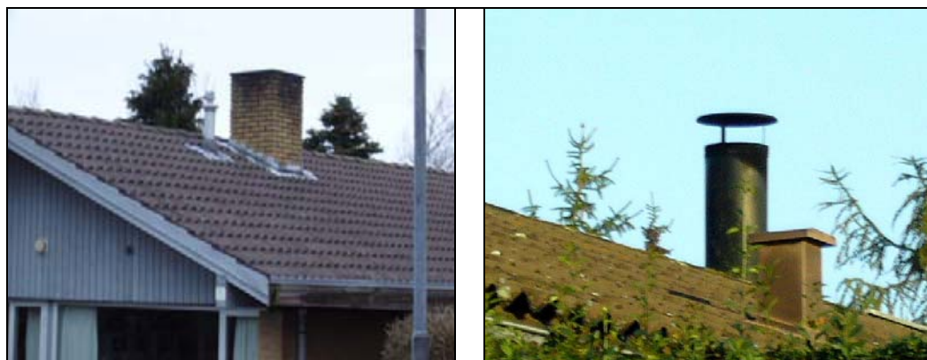
Figur 19. Eksempler på sodsværtning af skorstene
