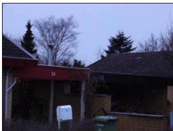
Figur 2. Eksempel på skorsten på brænde kedel i garagetilbygning til nr. 12. Kedlen anvendes ikke, dels p.g.a. dårligt træk, fordi den er for lav, og dels fordi røgen falder ned lige foran ejerens hus til højre i billedet.
