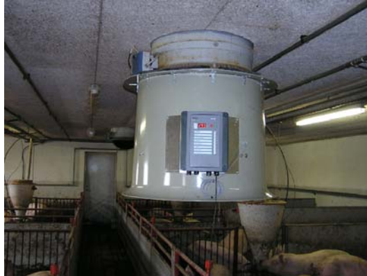
Figur 2. Luftydelsen ved fastlæggelse af lugt- og ammoniakemission kan bestemmes ved en direkte måling af luftydelsen med for eksempel en målevinge. Billedet viser en Ø800 enhed med målevinge af fabrikatet Fancom. Luftydelsen er proportional med målevingens omdrejnshastighed.
