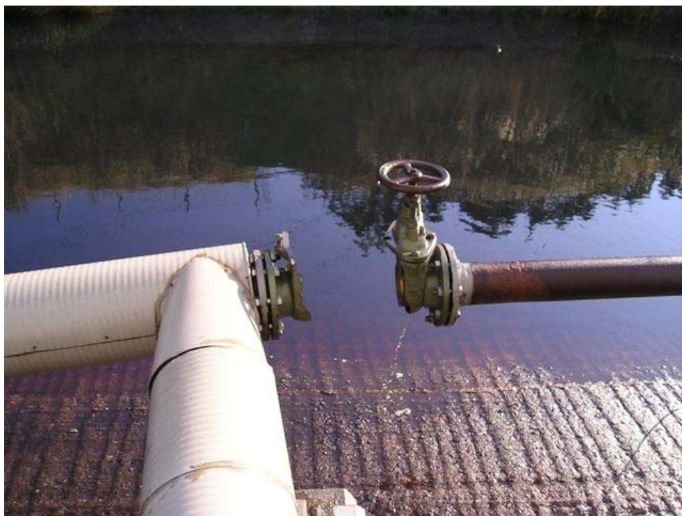
Sprængt ventil som følge af opvarmning af indespærret produkt i ledning. Gasolie i tankgård. /NIRAS, 2003/.
