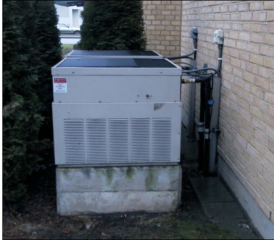
Figur 6.12 Udendørs køleanlæg placeret på et betonfundament, der står direkte på jorden.
