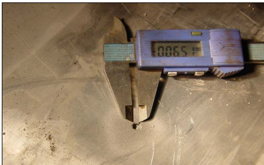
Figur 6.6 Korrosionsgrube i en 8 år gammel rustfri ståltank.
