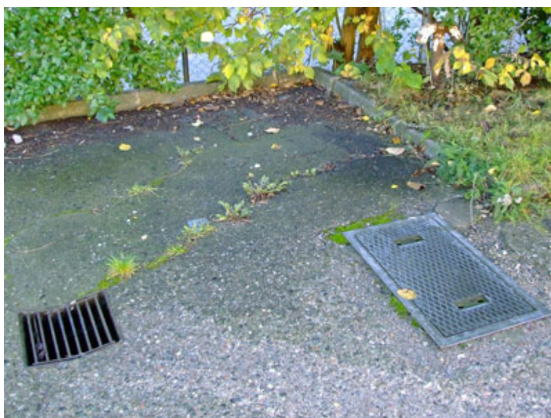
Figur 7.2. Defekt belægning ved påfyldningsplads.
