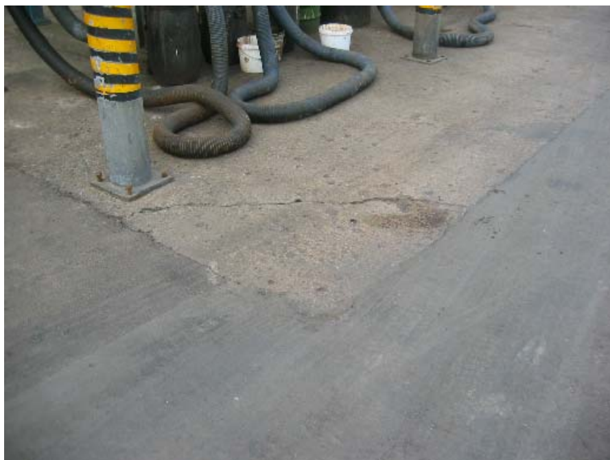
Figur 6.8. Skadet betonbelægning ved påfyldningsplads.
