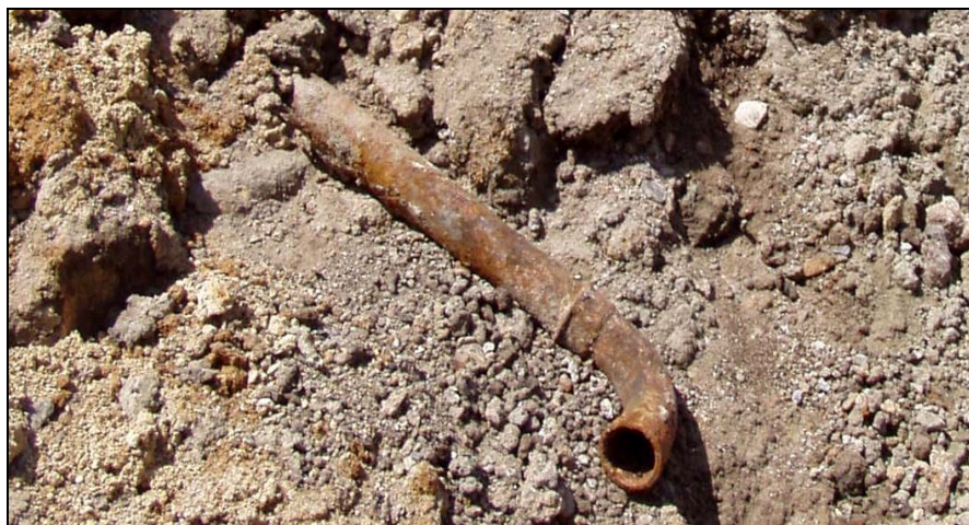
Figur 6.3 Stærkt korroderet sugerør fra nedgravet tankanlæg.
