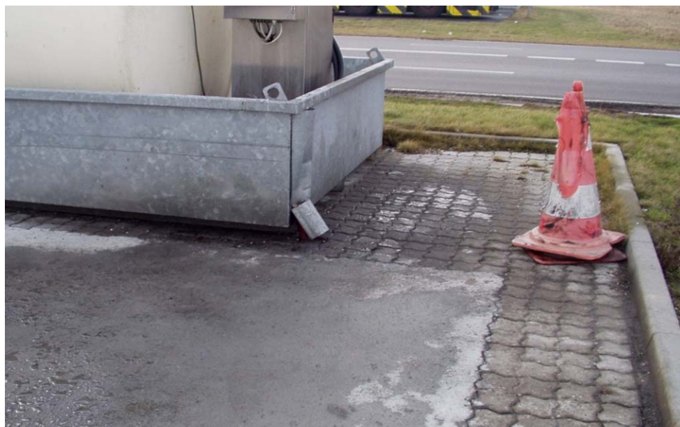
Figur 6.14 Påfyldningsplads i spildbakke på utæt flisebelægning.
