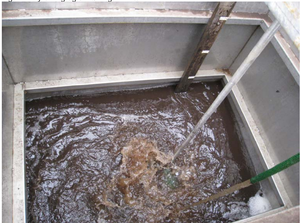
Figur 4.4 Fyldning og omrøring i 2 m 3 tank
