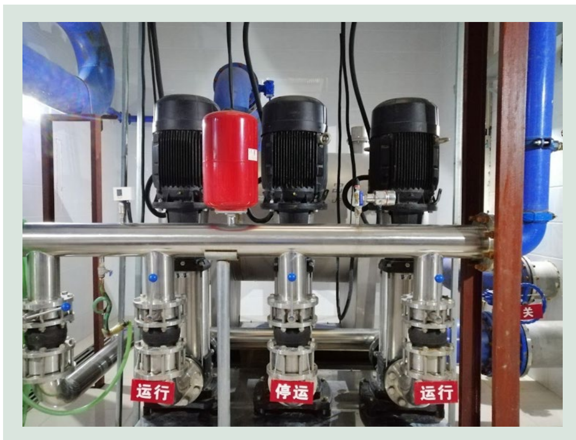
FIGUR 7. Ny pumpestation i Changchun med Grundfos pumpearrangement, online dataovervågning mm.
